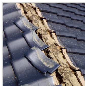
半端瓦の無繫結による脱落
