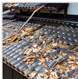
脱落した瓦による二次被害
