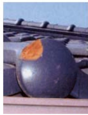
凍害の影響で崩壊が進んだ瓦
