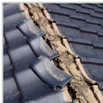
半端瓦の無緊結による脱落
