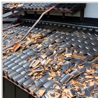
脱落した瓦による二次被害
